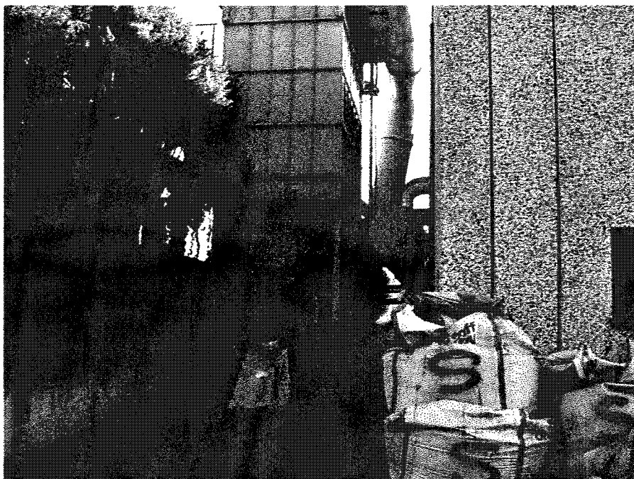
Fig. 3.14.10 Particolare dell'impianto abbattimento delle emissioni in atmosfera con recupero in sacchi delle polveri di sbavatura
