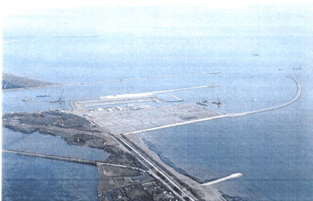
Bocca di Malamocco: veduta d'insieme delle lavorazioni in corso. Dal basso verso l'alto il rilevato provvisorio con le piastre per la prefabbricazione dei cassoni, la conca di navigazione e le opere di spalla sud con il terrapieno e la vasca per gli impianti di barriera.
