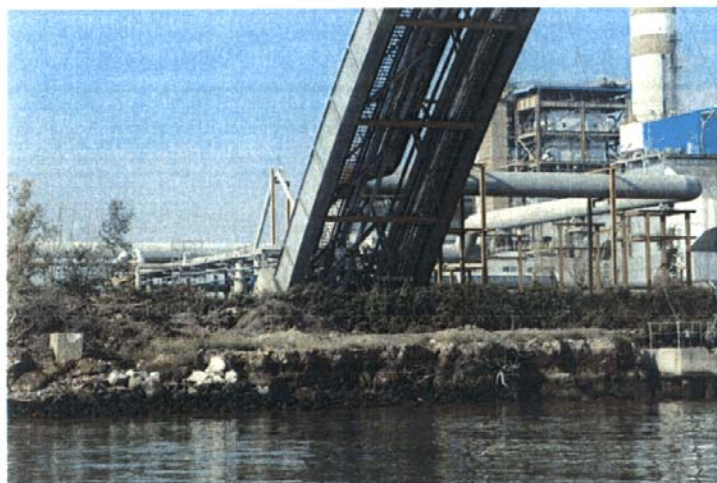
Canale Industriale sud sponda sud, sponda Syndial - Polimeri Europa. Stato di fatto di un tratto di marginamento.
