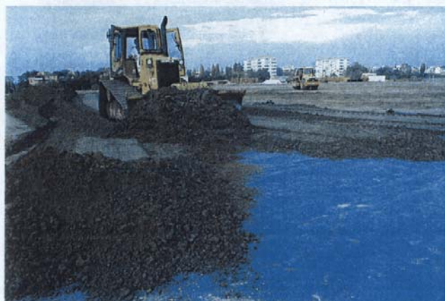
Barena del Passo a Campalto. Realizzazione del diaframma di bentonite granulare (area fosfogessi). Riempimento del cassero della benna.
