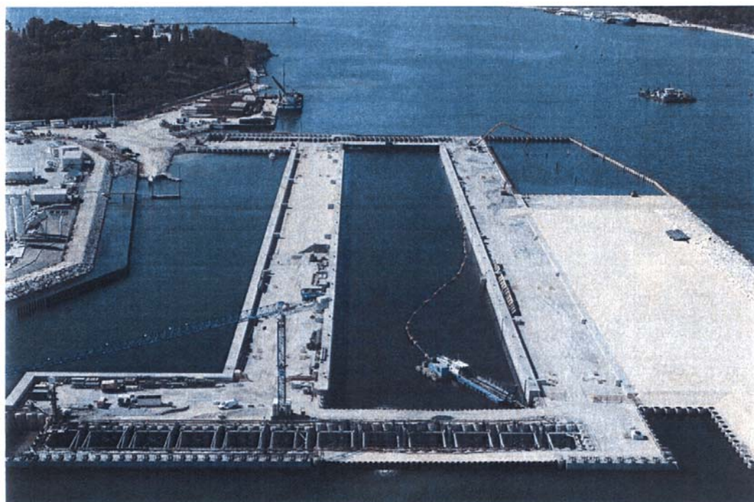
Bocca di Malamocco : In primo piano la porta lato mare della conca di navigazione per grandi navi (centro della foto) che consentirà il transito a imbarcazioni con lunghezza fino a 280 m, larghezza fino a 39 m e pescaggio fino a 12 m. Sulla destra, il terrapieno e la vasca ove verranno ubicati gli impianti e gli edifici tecnologici.
