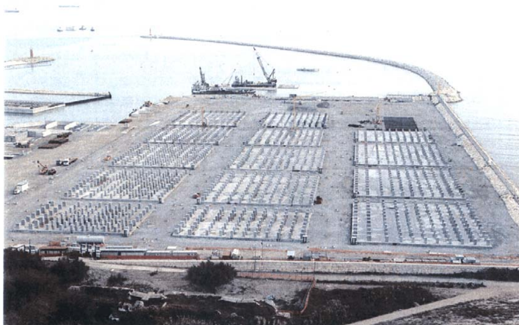
Bocca di Malamocco: cantiere, realizzato su un rilevato provvisorio, per la prefabbricazione dei cassoni di alloggiamento delle paratoie della barriera di S. Nicolò e di Malamocco: sono in costruzione le piastre ove pogeranno i cassoni durante la fase di prefabbricazione. Sullo sfondo la diga foranea.
