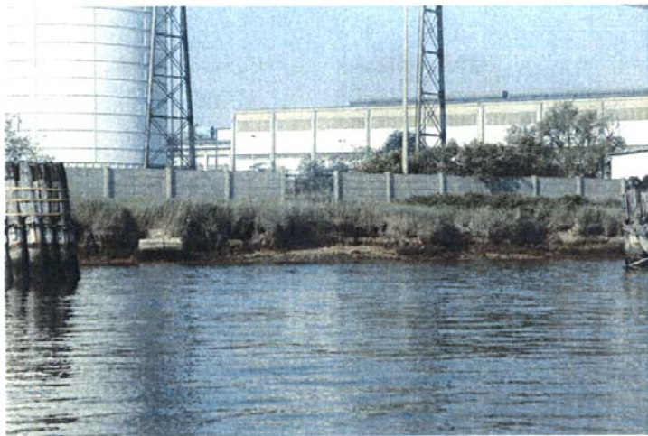
Canale Industriale sud sponda sud, tratto Decal - Italcementi. Stato di fatto di un tratto di marginamento.
