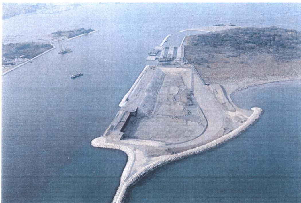
Bocca di Chioggia: In primo piano il bacino del porto rifugio lato mare, messo all'asciutto. Più in là le conche di navigazione con le strutture della spalla nord. Sullo sfondo il porto rifugio lato laguna.
