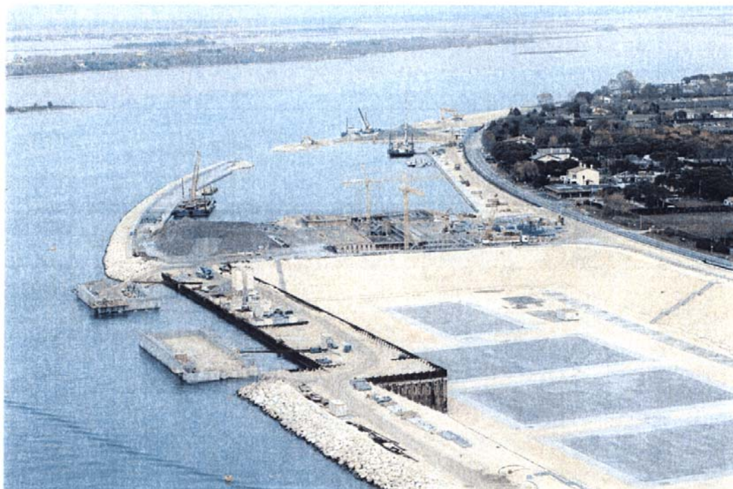
Bocca di Lido - Treporti : in primo piano la tura di prefabbricazione; più in là la conca di navigazione ed il porto rifugio lato laguna.
