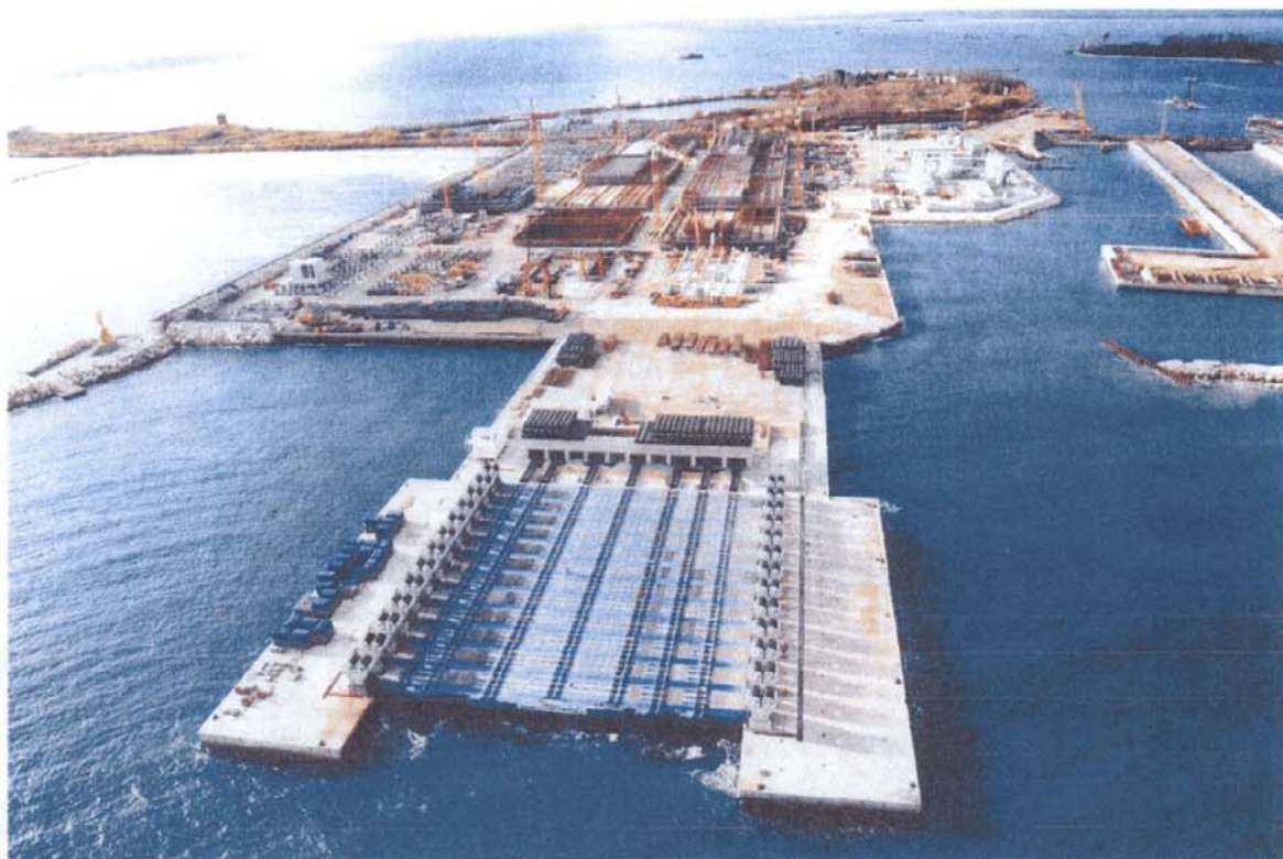
Bocca di Malamocco: veduta d'insieme del rilevato provvisorio sul quale si svolgono le lavorazioni di prefabbricazione dei cassoni per la bocca di Malamocco e San Nicolò. In primo piano la struttura syncrolift per il varo dei cassoni
