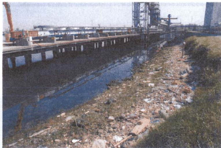
Canale Industriale Sud sponda Syndial Polimeri Europa: stato di fatto di un tratto di marginamento
