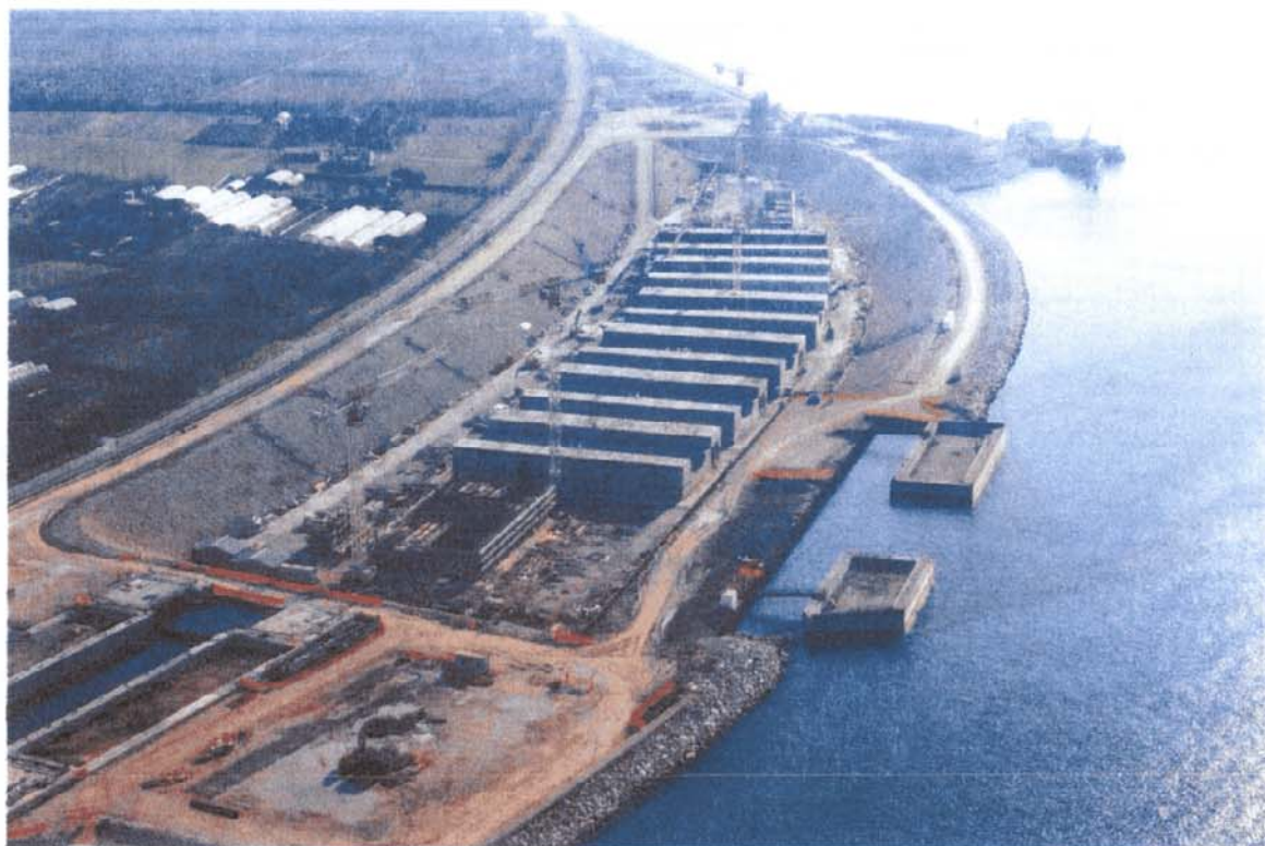
Bocca di Lido - Treporti : in primo piano, il bacino lato mare messo all'asciutto per essere utilizzato come tura per la prefabbricazione dei cassoni sui quali verranno incernierate le paratoie della barriera di Treporti
