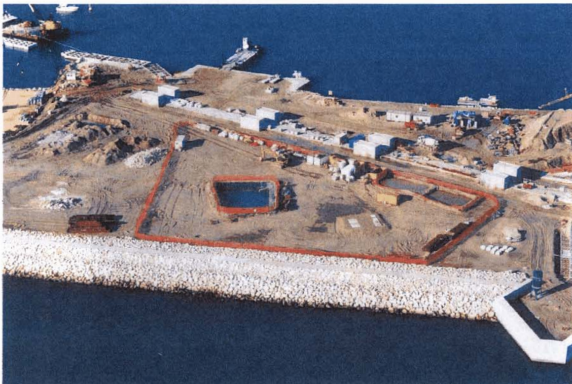
Bocca di Lido : sull'isola nuova, in primo piano il cantiere per la realizzazione delle teleguidate; in secondo piano il tunnel che ospita alcune opere elettromeccaniche per il funzionamento delle paratoie
