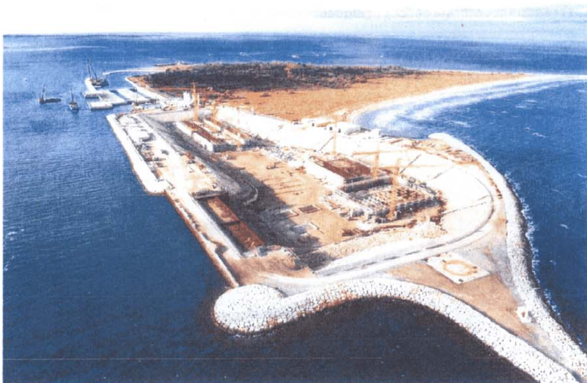
Bocca di Chioggia : in primo piano il porto rifugio lato mare messo all'asciutto per essere utilizzato come tura per la prefabbricazione dei cassoni per la bocca di Chioggia; in alto le due conche di navigazione
