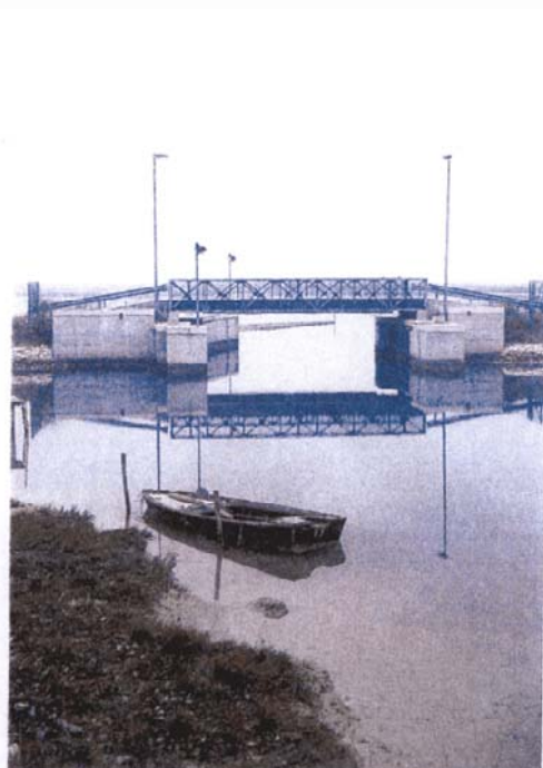
Di lato paratoie a "porte vinciane" per la protezione del territorio delle Mesole
