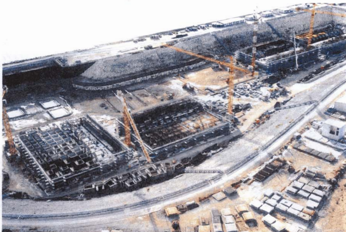
Bocca di Chioggia : il bacino del porto rifugio lato mare. Il bacino è stato messo all'asciutto e utilizzato come "tura" per la prefabbricazione dei cassoni di alloggiamento delle paratoie della barriera di Chioggia
