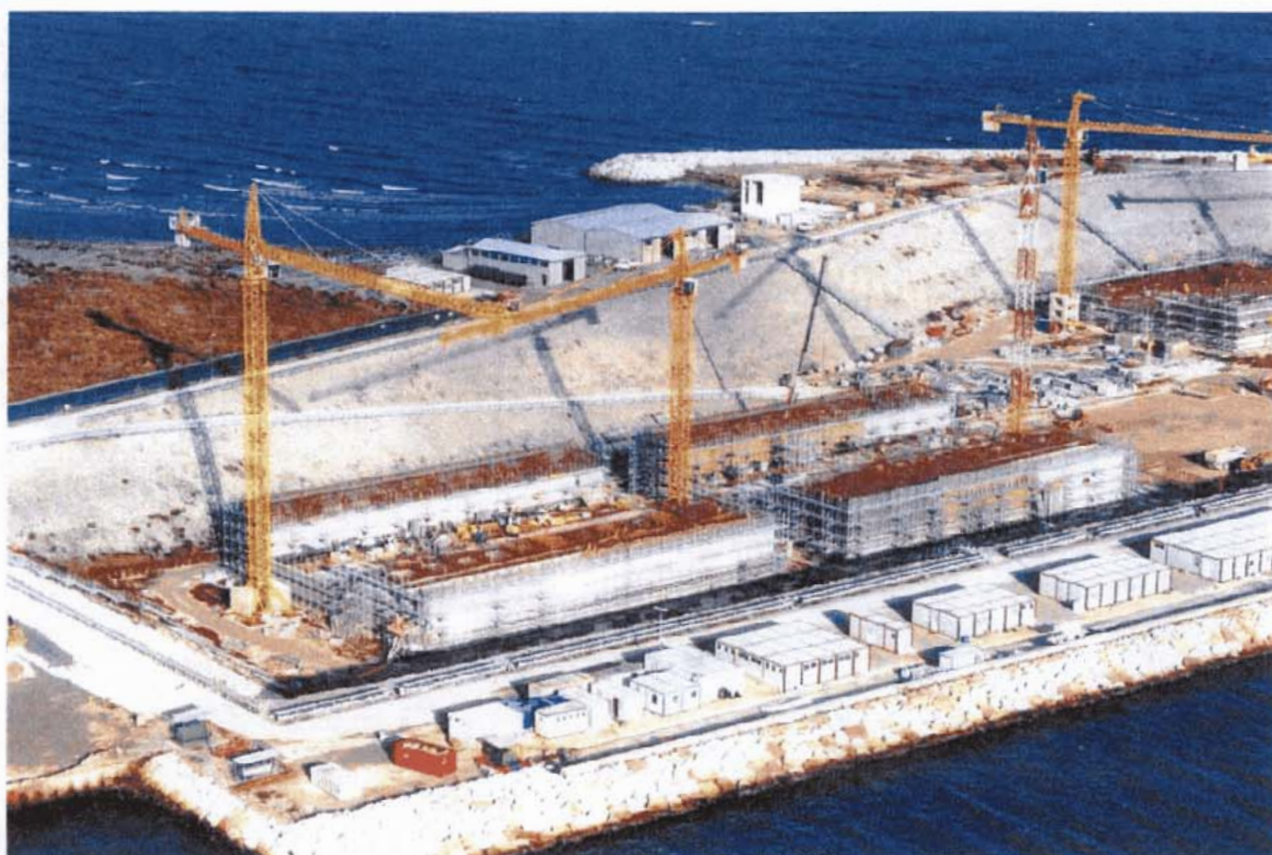
Bocca di Chioggia : particolare delle lavorazioni per la realizzazione dei cassoni di alloggiamento delle paratoie della barriera di Chioggia
