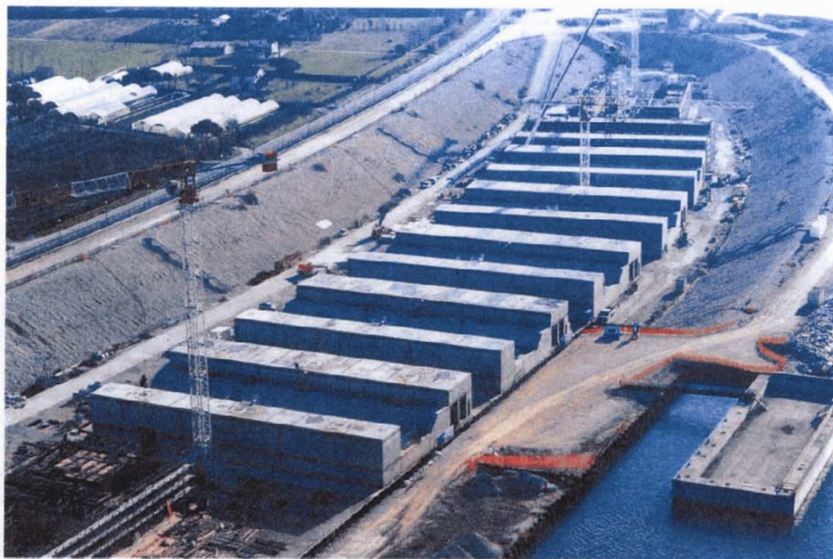
Bocca di Lido - Treporti: a destra, i cassoni prefabbricati in calcestruzzo armato che andranno a formare la barriera di Treporti
