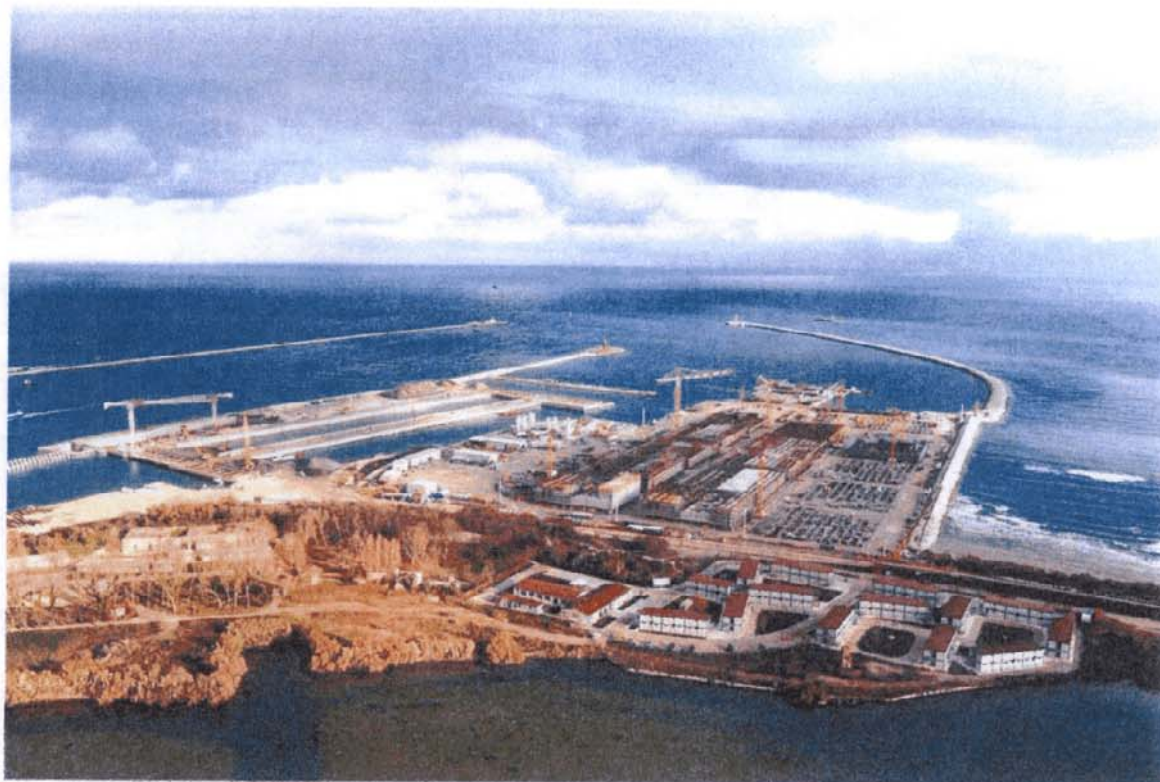
Bocca di Malamocco: veduta d'insieme delle lavorazioni in corso alla bocca di Malamocco
