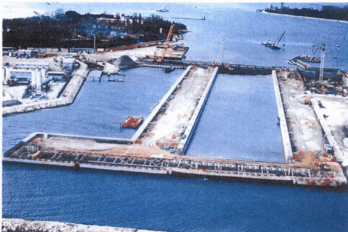
Bocca di Malamocco: veduta di dettaglio della conca di navigazione per grandi navi in avanzata fase di realizzazione
