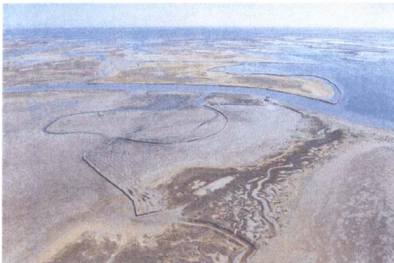
In questa foto, sono in fase di realizzazione le conterminazioni delle barene mediante l'infissione di pali in legno, seguendo delle specifiche sezioni, mediante mezzi meccanici
