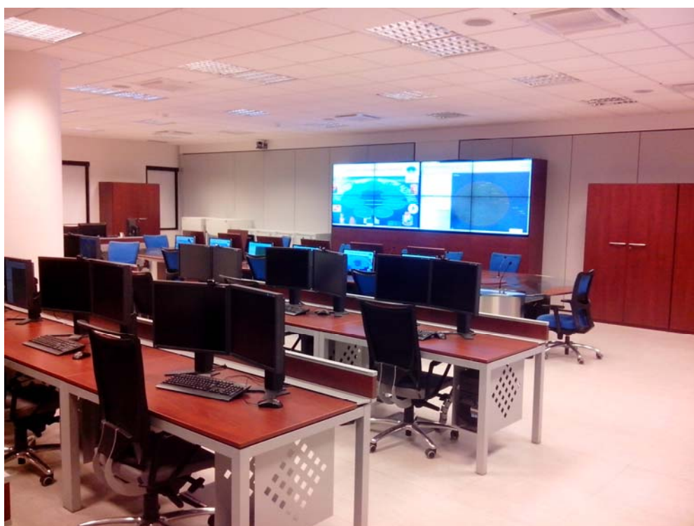
Figura 2 Panoramica delle postazioni degli operatori Sala CNISM
