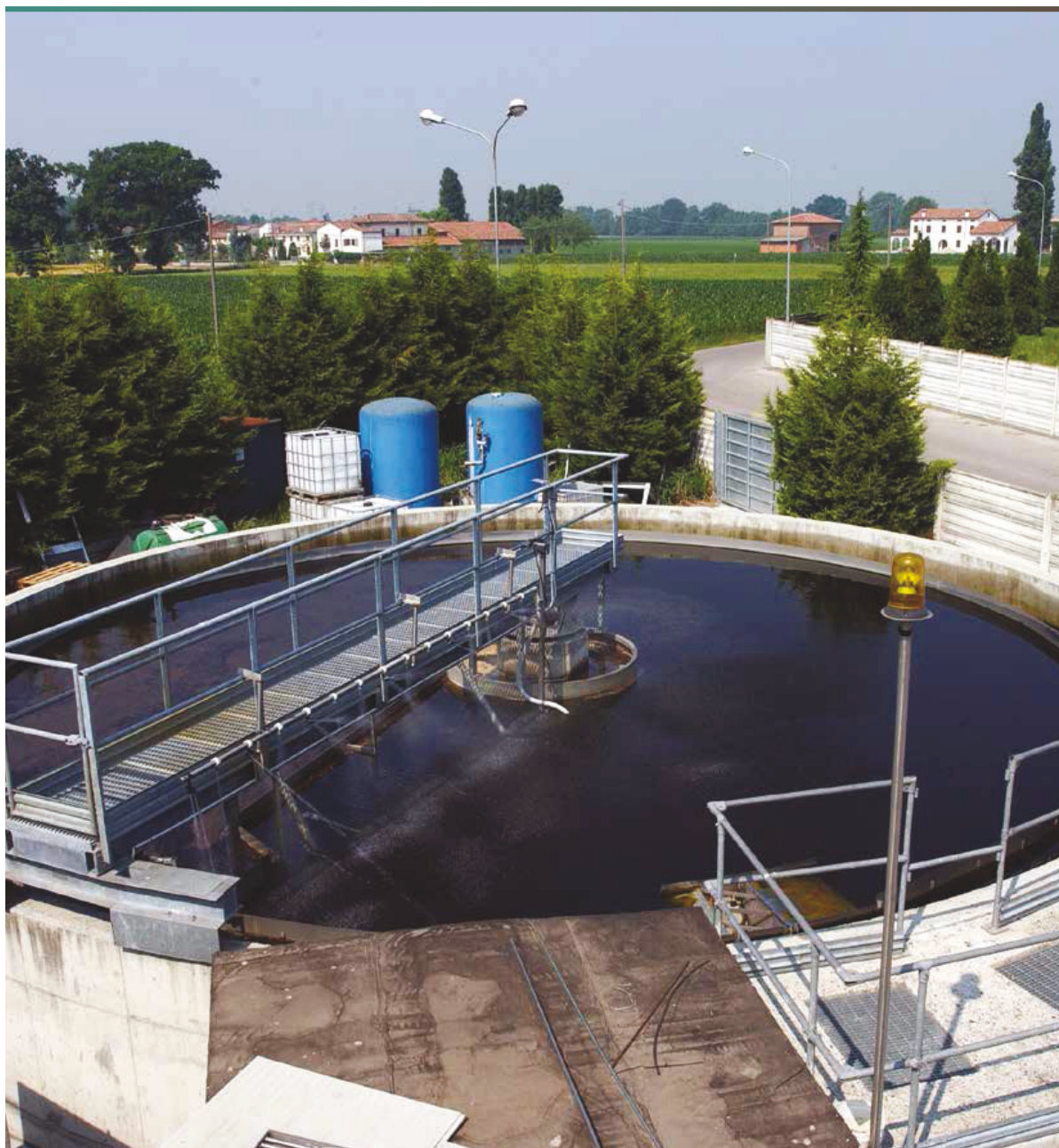
Foto 5.12 Sedimentatore con carroponte Fonte ISPRA Paolo Orlandi
