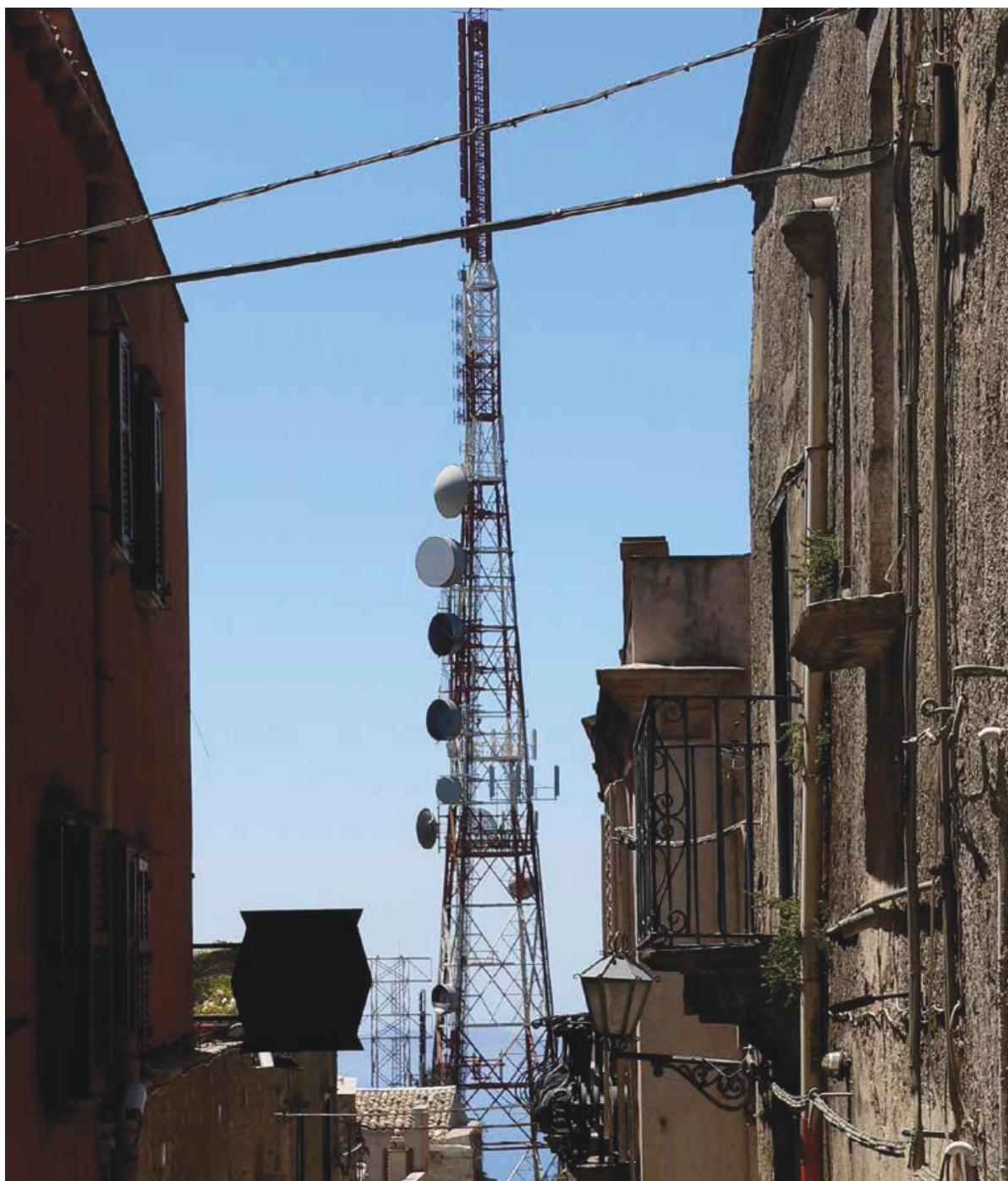
Foto 3.10 Ripetitore in ambiente urbano Fonte ISPRA Franco Iozzoli
