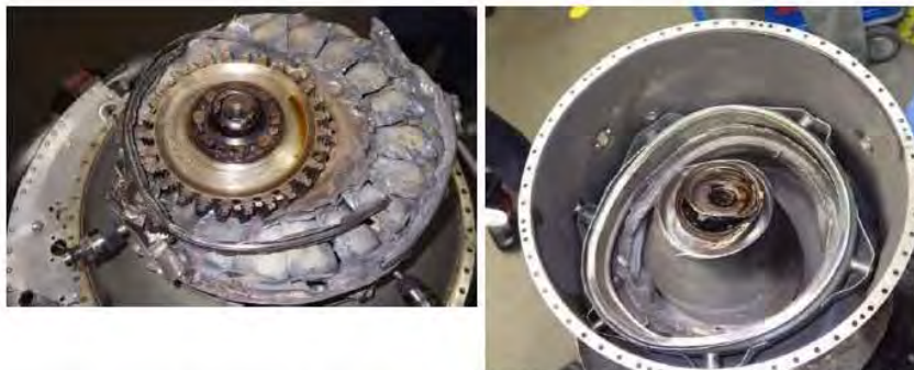
Foto 5: a sinistra, la power turbine separata dal PT shaft con parte dello stesso ancora vincolata; a destra, il supporting cone , al cui interno è visibile la sezione di PT shaft separata dalla power turbine .
