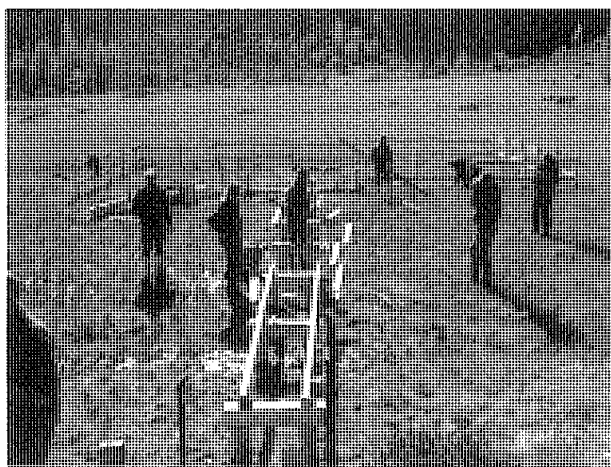
Fig. 34 - Alpe Arpiat: fasi dell'intervento, svolto con personale del Corpo di sorveglianza, per la costruzione della passerella di accesso alla zona di massima tutela.
