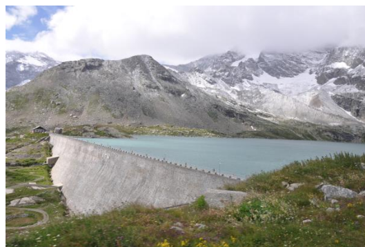
Fig. 2-3 - L'industria idroelettrica produce un fatturato molto elevato nel Parco. Foto archivio PNGP
