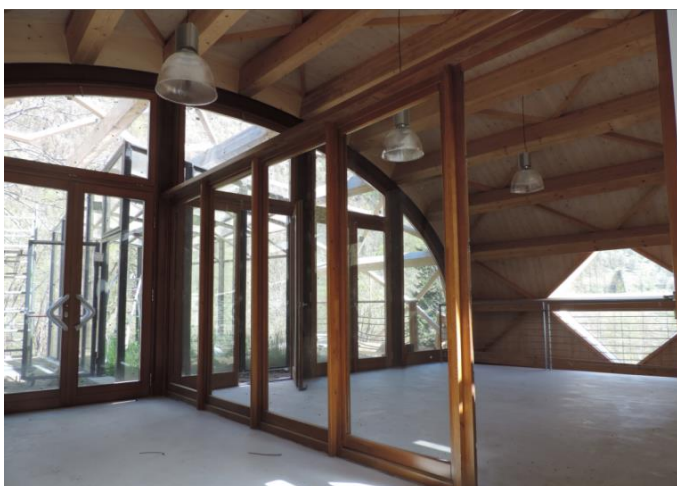
Fig.7-5 - La parte di fabbricato che aggetta sulle serre esterne. Foto B. Rosai
