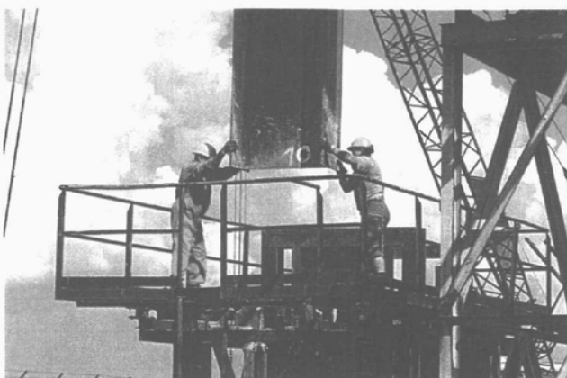
Canale industriale Sud. Una fase dei lavori per la messa in sicurezza della sponda sud, riva in corrispondenza dell'area 43 ettari.
