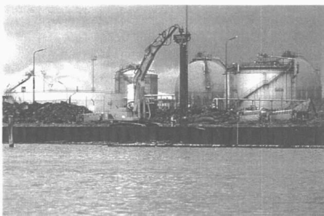
Canale industriale Sud. Infissione del palancolato di acciaio a ridosso della riva nord preesistente.
