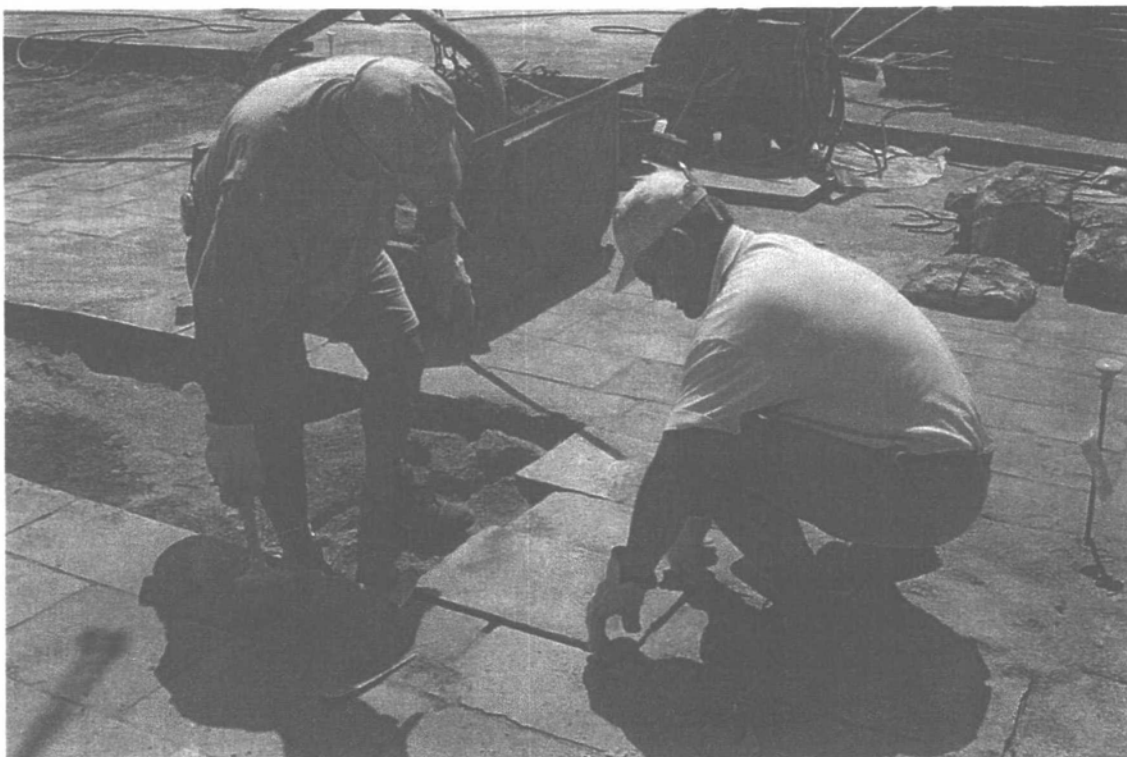
Difesa rive bacino S. Marco tra Ponte della Paglie e Ponte del Vin. Un tratto della riva durante i lavori.
