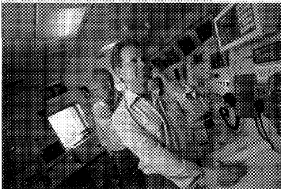
Regno Unito Mare del Nord, piattaforma "Tiffany", sala controllo
